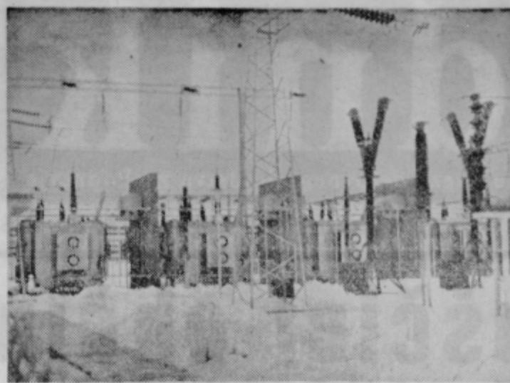
RTP 220/110 kV Cirkovce
