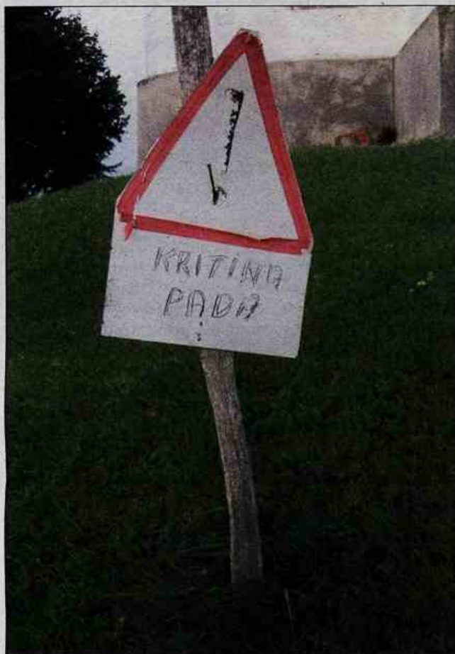
Resno opozorilo. Na zvoniku manjka že večji kos skrilavca.
