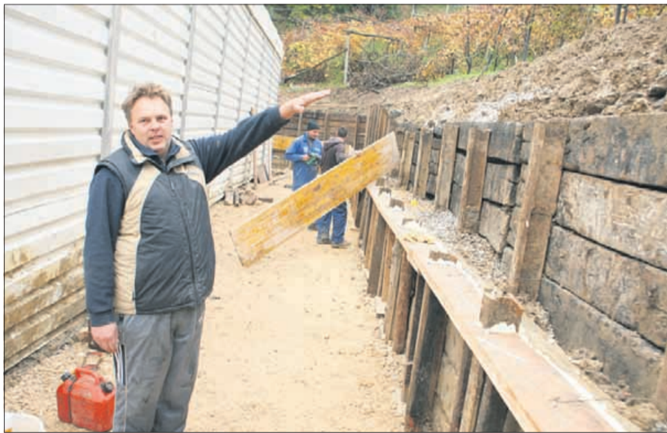
Po mesecu dni pri Škorjančevih v Marija Gradcu še zmeraj sanirajo plaz, ki je skoraj prevrnil skladiščno halo. Janez kaže, kako visoko je zasulo objekt.
