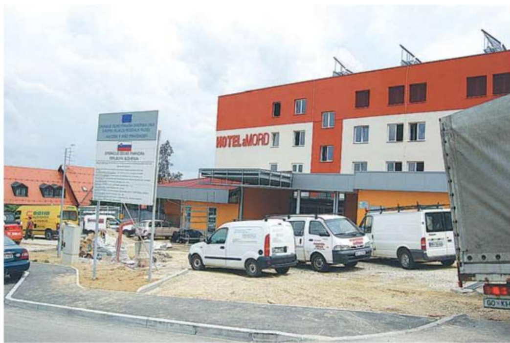
Hotel a Mord pri Mali Nedelji bo kmalu končan. Imel bo osemindeset sob z večjo restavracijo, pokriti bazen, savne, solarij in prostor za masažo. Foto: M. H.
