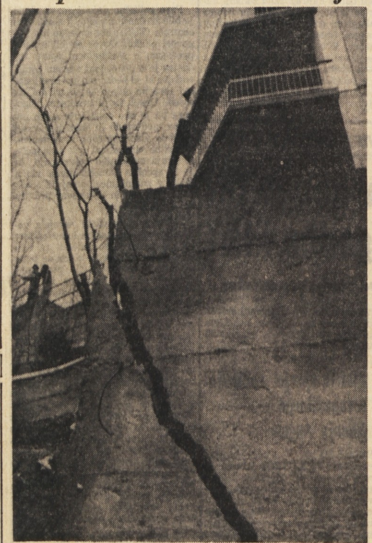
Razpoka v opornem zidu na Brandežiji
