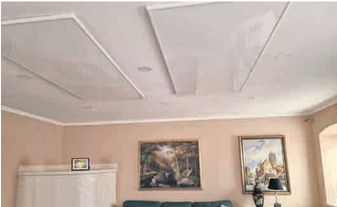
IR-paneli, ki so jih energetski strokovnjaki pred časom še močno priporočali, naj bi bili posledje dovoljeni le, če jih poganja elektrika iz obnovljivih virov energije.
