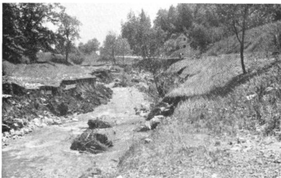
Slika 1. Ob neurjih vode izredno močno narastejo in pustošijo ob strugi navzdol. V času junijske poplave 1954 je Pirešica takole poglobila in razširila svojo strugo malo nad vasjo Pirešica
