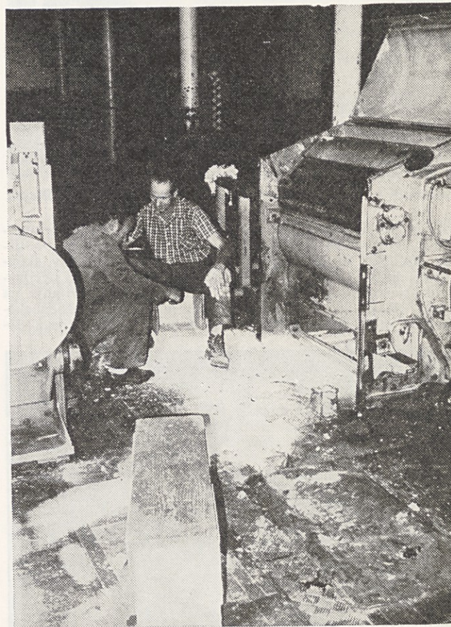
V čistilnici sintetične so remontni delavci pri otepalniku za menjali odvajalno glavo
