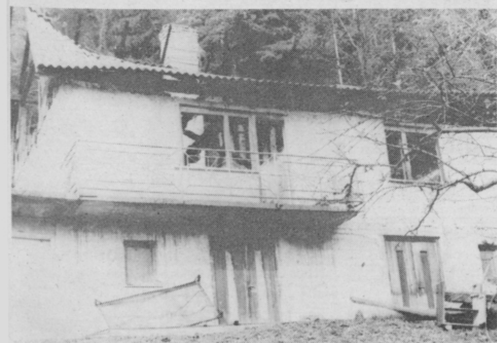
Pri večjih nesrečah so običajno poškodovani tudi oplesk, tapete, zidne, podne in stropne obloge ter stekla v oknih in vratih stanovanja. Za vračilo škode je treba zanje skleniti poseben dogovor.
