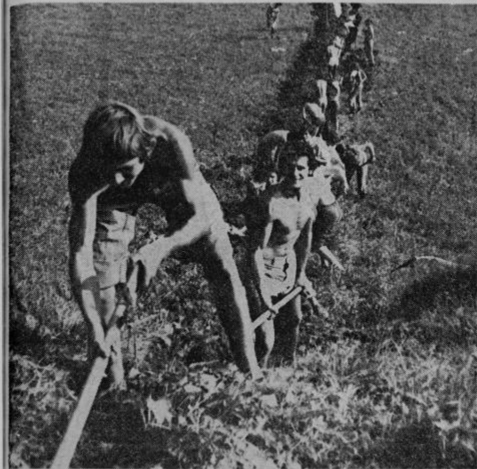
Takole so poprijeli za krampe brigadirji na Kozjanskem. Na posnetku je del tehnične čete v sestavi brigade rdečega križa »Dr. Mladen Stojanović«, kjer so zbrani mladinci iz vseh jugoslovanskih republik in pokrajin. Minuli teden so kopali priključek za vodovod pri Marofu, kjer cesta zavije s Planine proti Jurklostru. Foto: D. MEDVED
