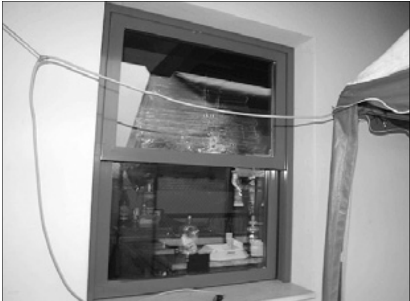
Poškodovana okno in vrata bara ob nogometnem igrišču v Sovodnjih
