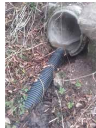
Turjak-iztok iz greznice speljan v propust
