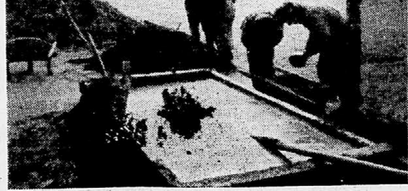
V Budimpešti so obnovili in popravili več precej stavb, ki so bile lani oktobra poškodovane. Na sliki: Delo na ulici sredi mesta, kjer so bile lani oktobra zelo hude burbe.
