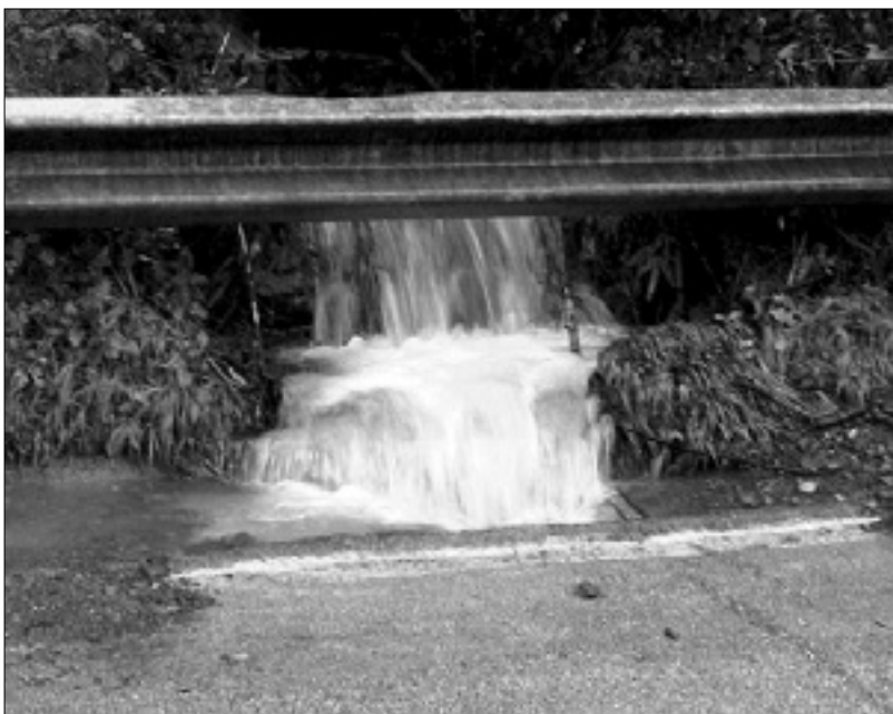
Odtočni kanal ob cesti v dolini Grojnice ne uspe požreti vse vode
