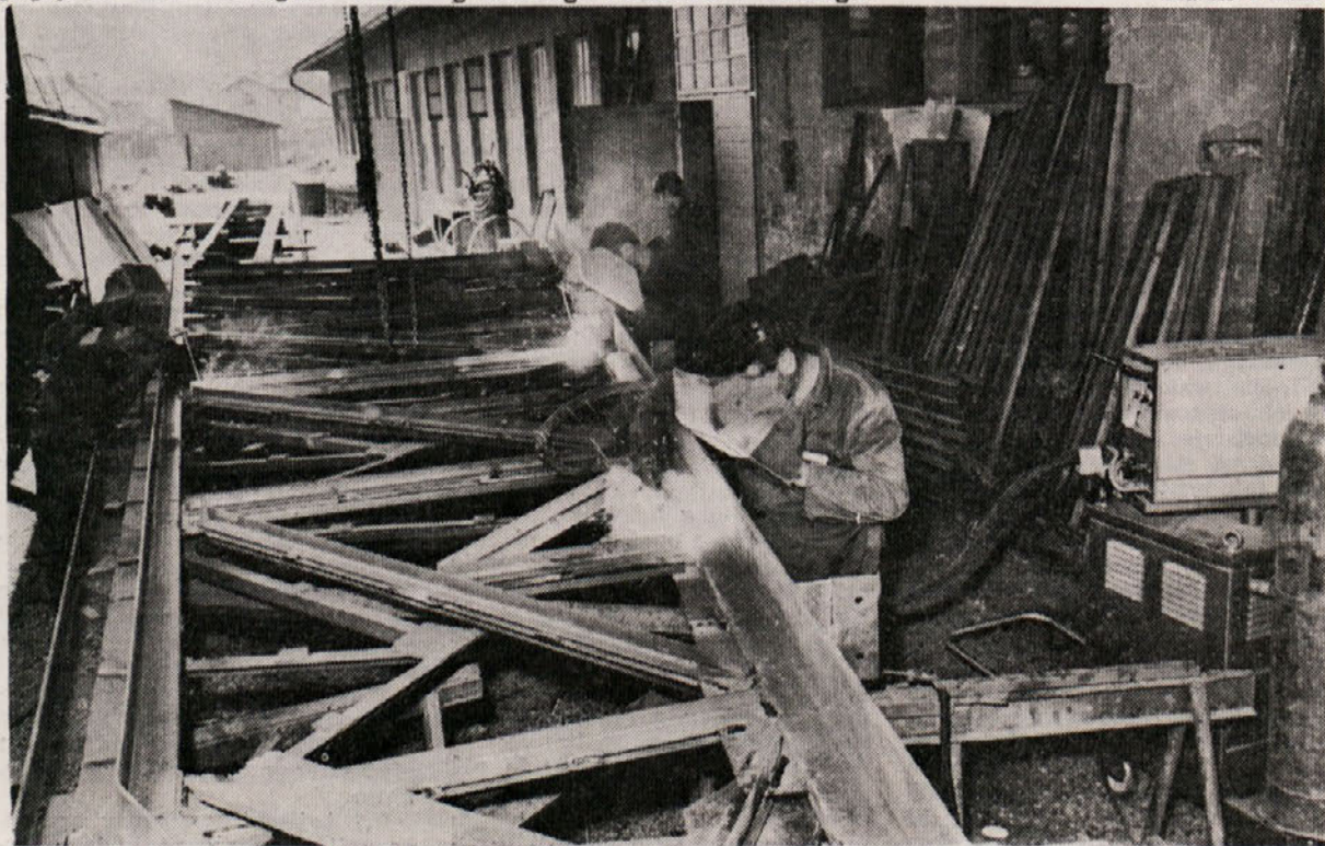
Sedanji ključavničarski obrat v TOZD PO, ki ga je nujno potrebno modernizirati.
