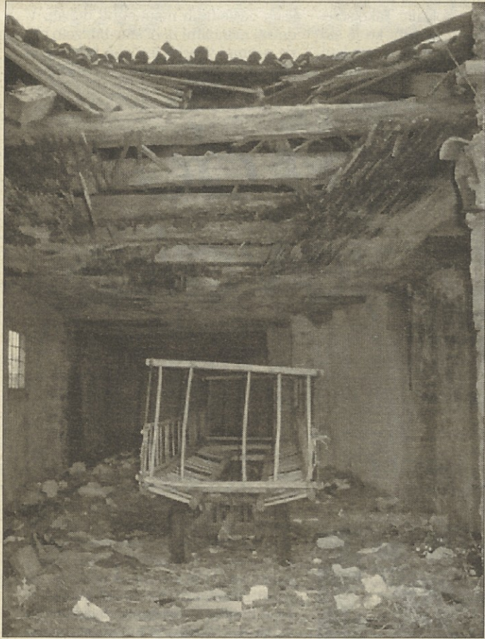
Hlev pod Pregarjami je razpadajoči ostanek povojnega časa.
