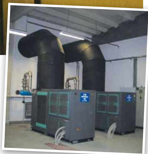
Rekuperacija toplote pri kompresorjih
