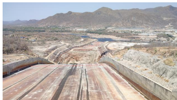
Slika: Prelivna polja pregrade Grand renaissance in posledice erozije dolvodno od prelivne drče.
