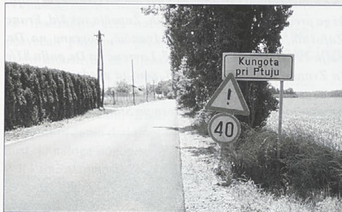
Manjka še zgornji sloj asfalta. Foto: BT
