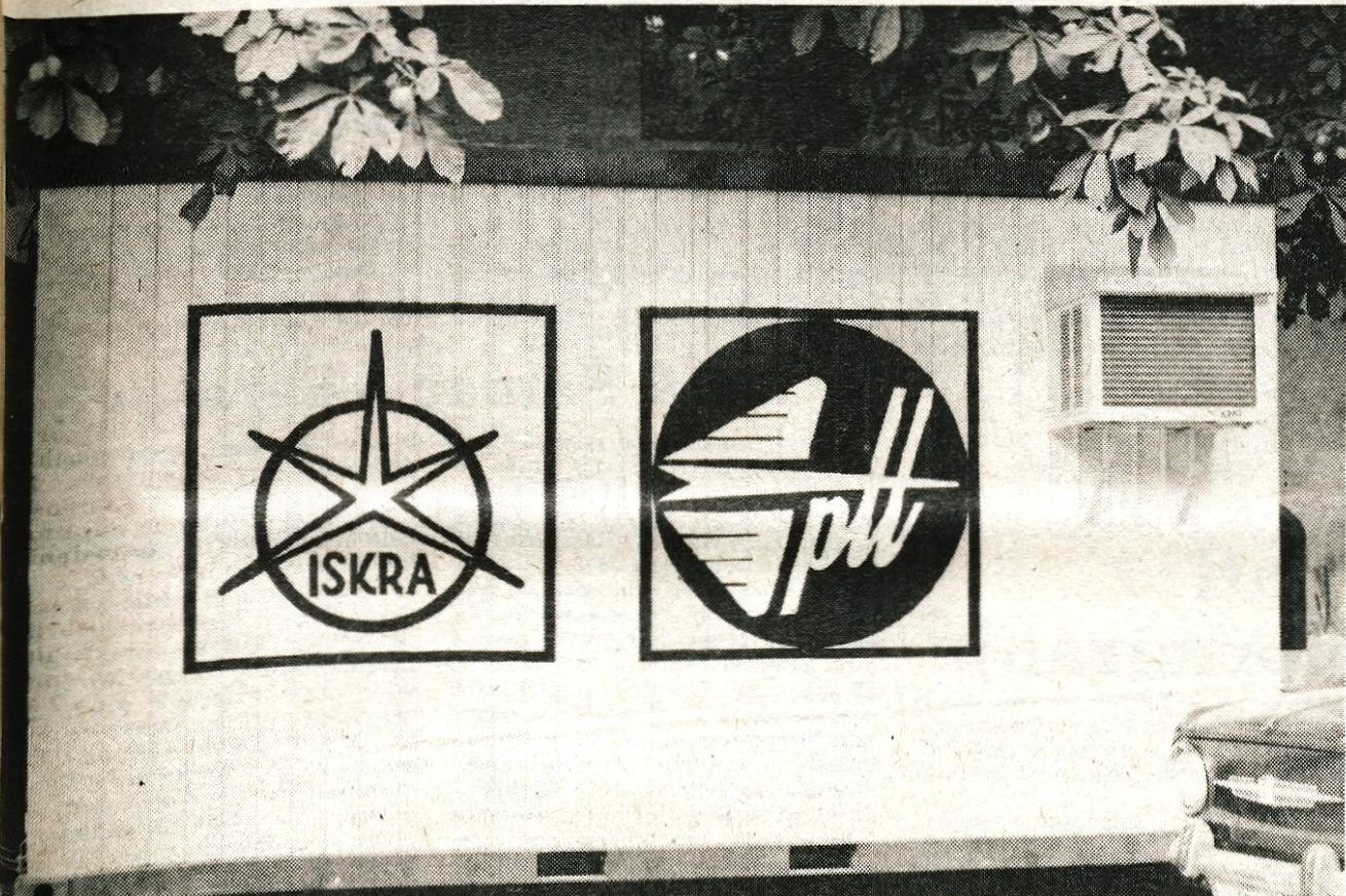
Iskrina avtomatska telefonska centrala Sistem crossbar montirana v vsebniku (kontejnerju). S takšnimi centralami bi najhitreje in z najmanjšimi stroški lahko vključili v telefonsko javno omrežje manjše kraje in vasi.
