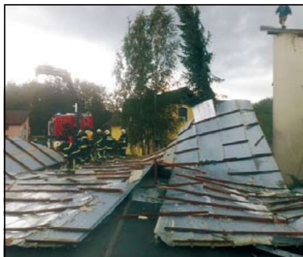
Poškodovana streha na podružnični šoli v Tunjicah ob neurju s točo, avgust 2008. Foto: PGD Kamnik.
