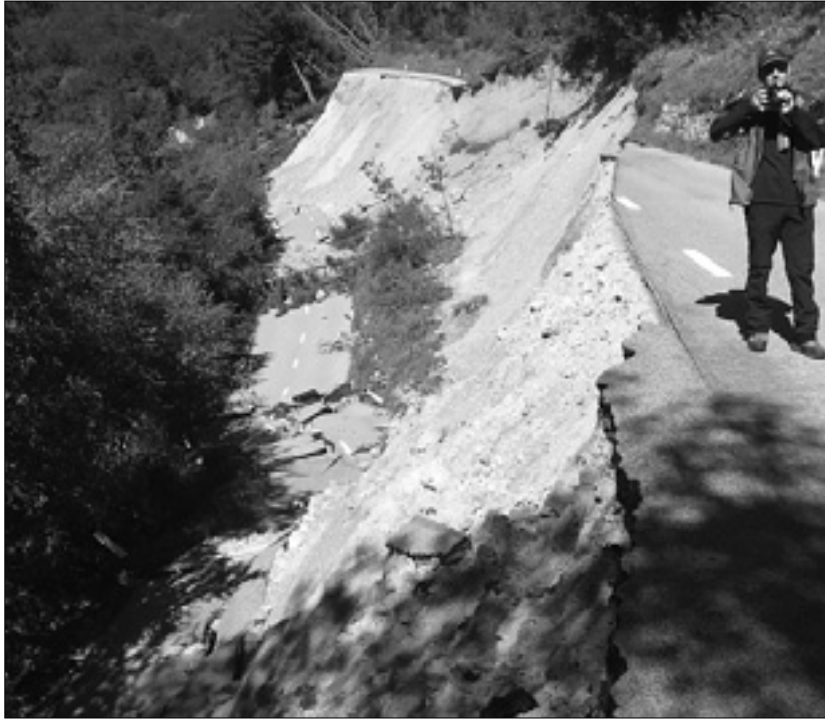
Plaz Stogovce na regionalni cesti med Lokavcem in Predmejo v ajdovski občini
