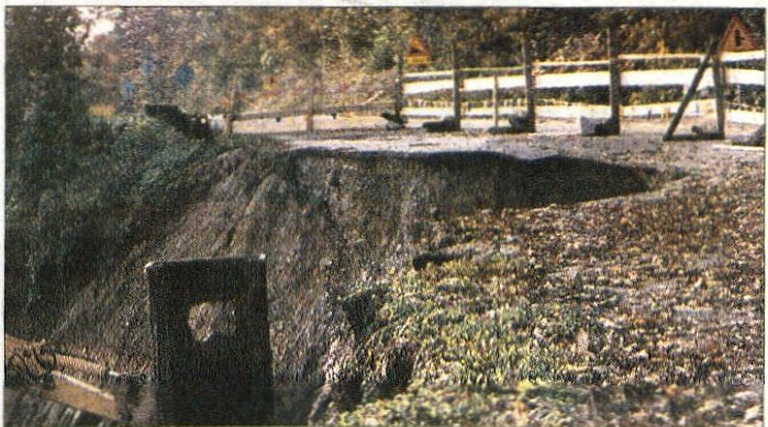
Plaz, ki se je sprožil v ponedeljek, povzročil ponovni udor že tako nevarnega odseka ceste v Seničnem.
