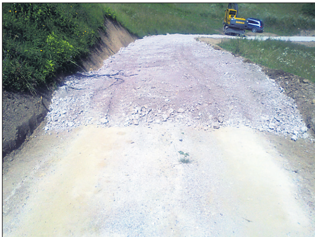
V občini Podlehnik bo kmalu dobilo asfalt 2,3 kilometra makadamskih cest, zaradi odločitve SVRL, da pol denarja občinam nakaže šele naslednje leto, pa je zmanjkalo sredstev za sanacijo cestnih plazov.
