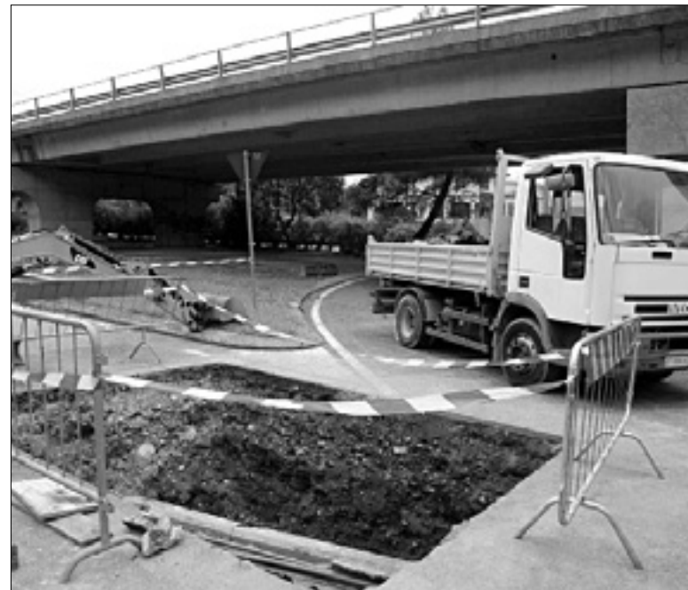
Jama v cestišču zaradi odpravljanja okvare pod nadvozom
