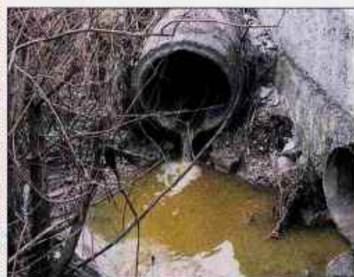
Iz kanalizacijske cevi teče v potok rjavkasto rumena tekočina, ki ne pušča mastnih madežev in se meša z vodo.
