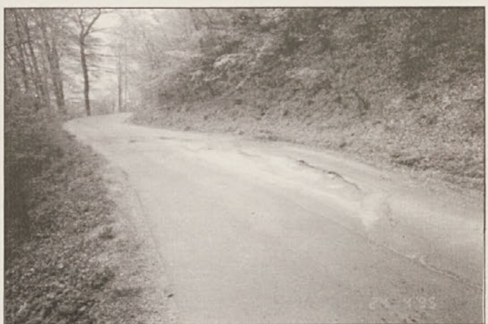
Deformacija vozišča na lokalni cesti Trbovlje - Klek
