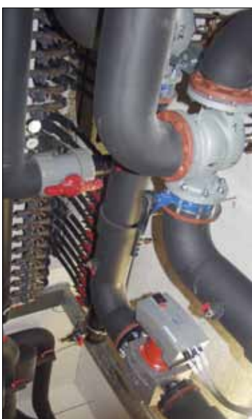
Del zahtevnih instlacij v strojnici za upravljanje z geosondami
