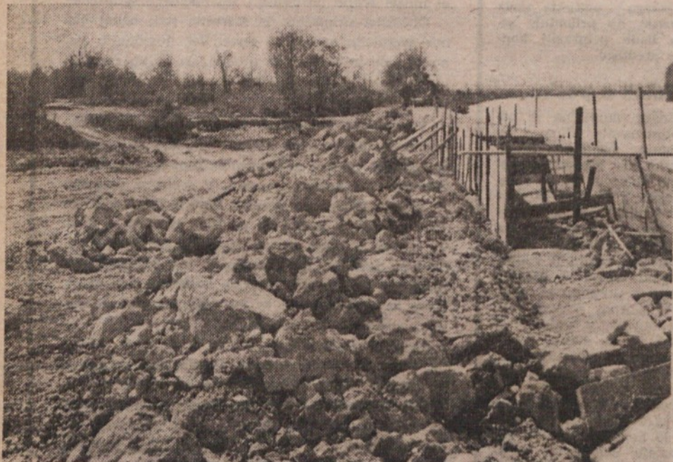
Tudi ta škarpa od šentjakobskega mostu proti Zalogu je bila že uničena, čeprav je pred leti veljala precej denarja. Ker je od varnosti desnega brega Save odvisno več sto hektarov rodovitne zemlje, je vodna skupnost Ljubljana-Sava začela popravljati porušeno škarpo.
