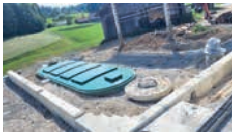
Takole je izgledalo, ko je bila že nameščena čistilna naprava.
