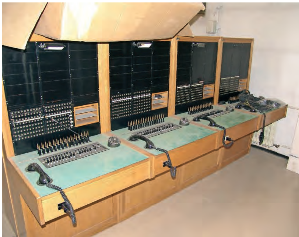
Stare induktorske posredovalne mize, na katere so bili priključeni krajevni in medkrajevni prednostni uporabniki. (foto: Jernej Bizjak)
