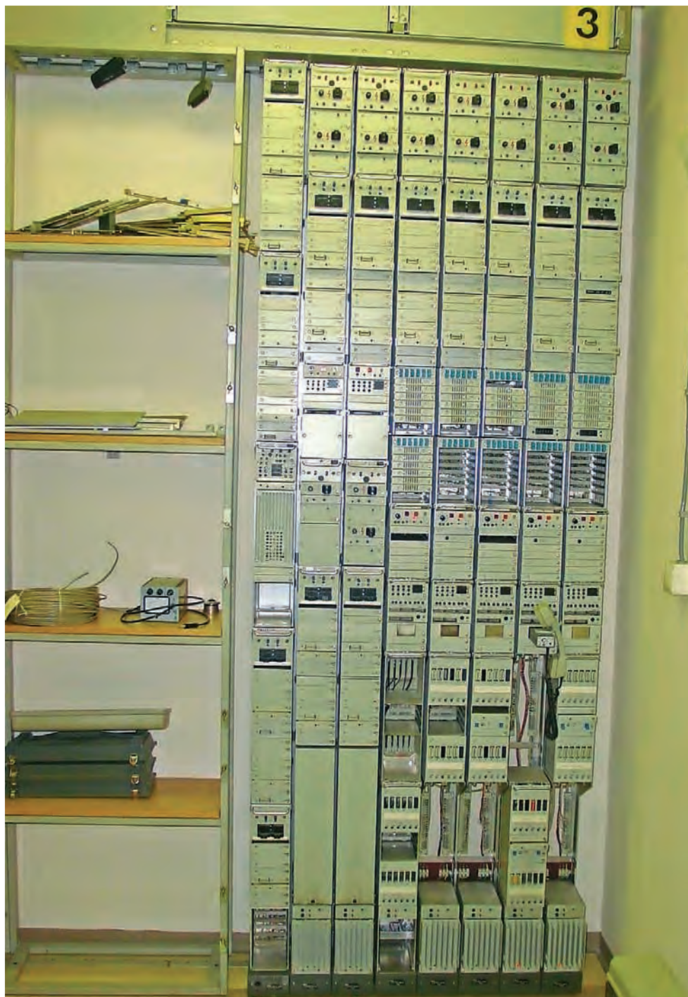
Rezervni center Kočevje je imel prenosno opremo v VSEP vertikalni izvedbi v stojalni vrsti. (foto: Marjan Kleva)
