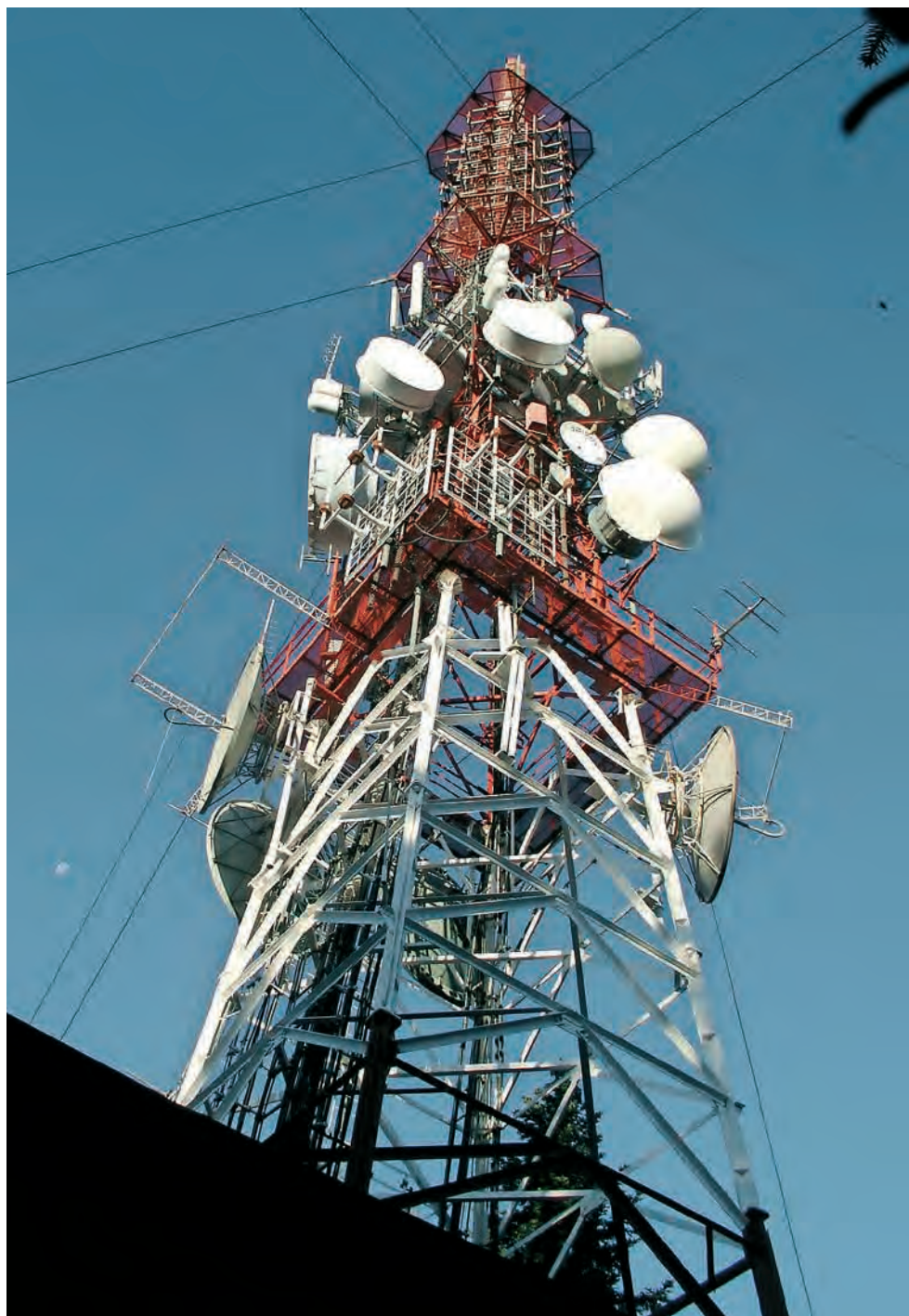
Antenski stolp na OC Pohorje. Posnetek je z dneva odprtih vrat tega objekta, 30. septembra 2018. (foto: Stane Koželj)
