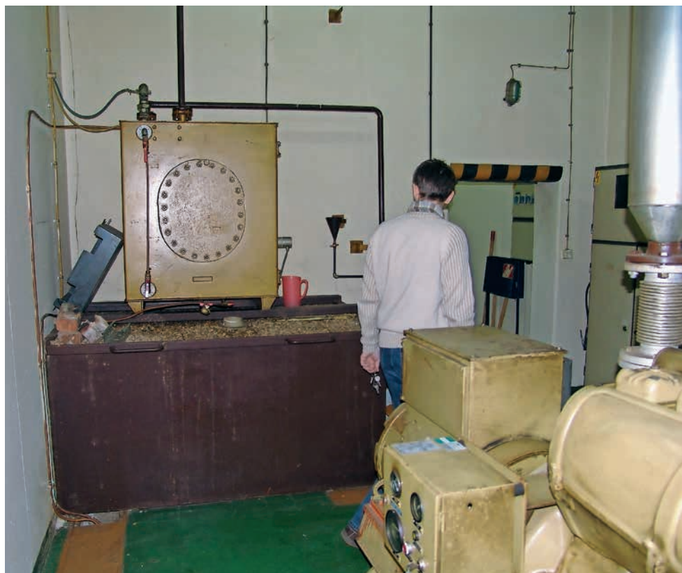
Električni generator v podzemnem objektu Dolenjske Toplice je zagotavljal popolno avtonomijo delovanja. (foto: Jernej Bizjak)
