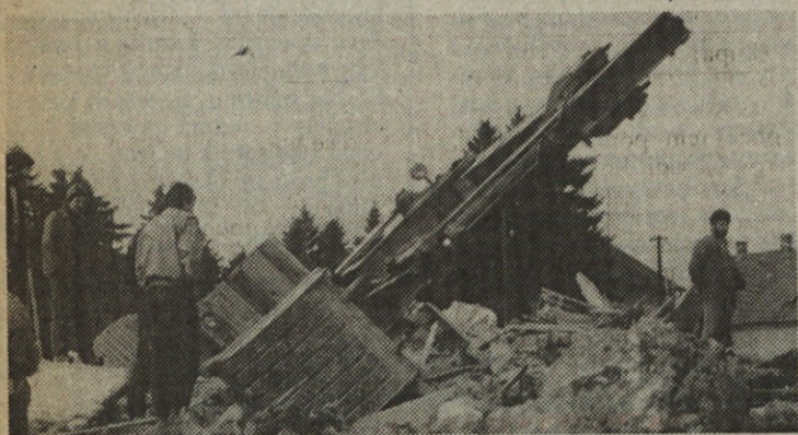
Kletna plošča je pod težo bagra popustila
