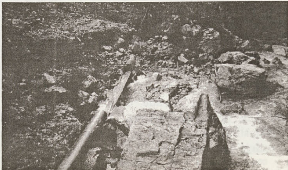
Na cevi male elektrane v Dolenjem Potoku so se usuli več ton težki kamniti bloki.
