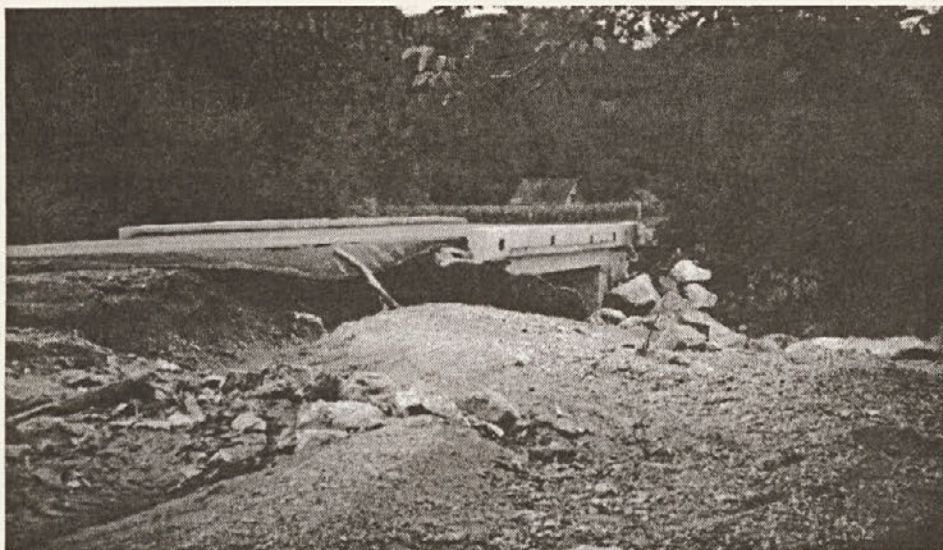
Na cesti v Osilnico se tudi po odstranitvi plazov skrivajo pod asfaltom nevarne luknje...
