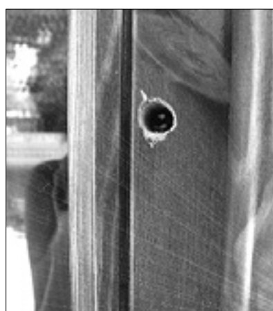
Izvrtna luknja za vlom v stanovanje
