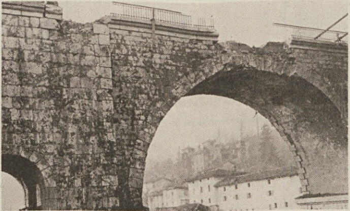
Močno poškodovan železniški most v Rubijah. V ozadju prav tako poškodovan grad s hišami
