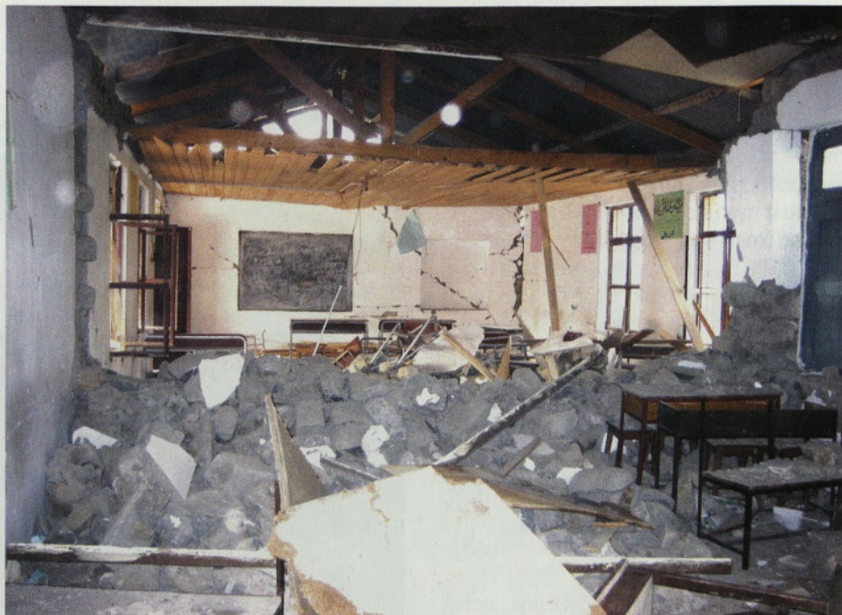
Slika 6 • Lesena strešna konstrukcija šole, porušeni prečni zid in močno poškodovano obodno zidovje
