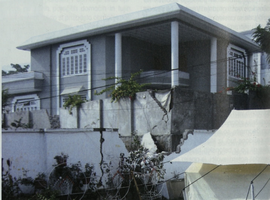
Slika 10 • Muzafarabad: opečna hiša v ozadju, soseda hiše na sliki 9, je potres prestala brez poškodb. Poškodovana je le ograja, sezidana iz betonskih blokov
