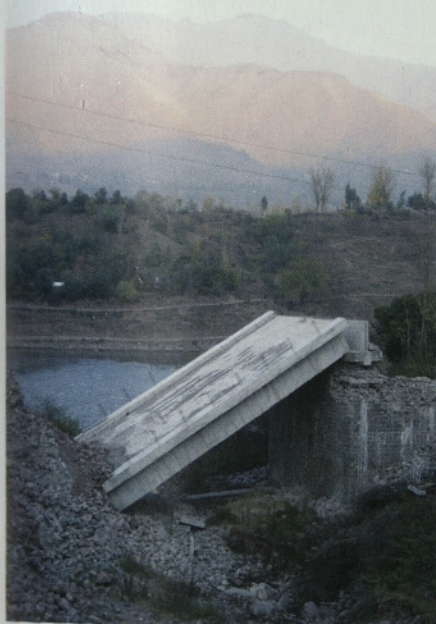
Slika 20 • Padec nove prekladne konstrukcije cestnega mostu zaradi prevrnitve krajnega opornika
