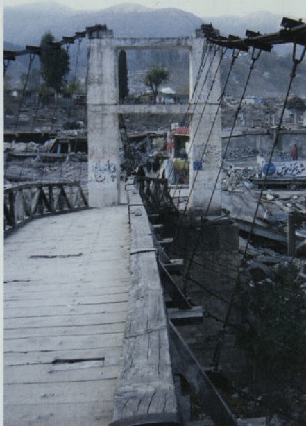
Slika 22 • Balakot: močna deformacija visečega mostu je posledica velikih zdrsov bloka, v katerem so sidrani kabli za bočno zavetrovanje
