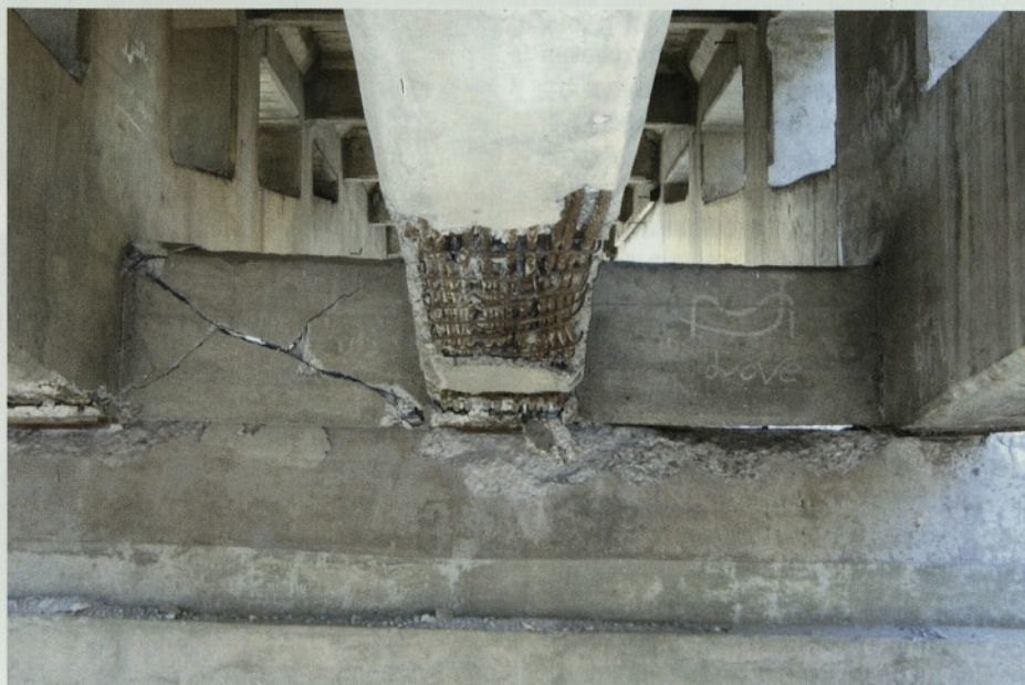
Slika 21 • Balakot: hude poškodbe prekladne konstrukcije mostu na vmesni podpor
