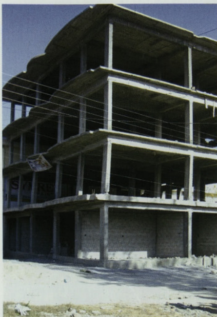
Slika 13 • Abotabad: v eni smeri šibki stebri, stopnišče v vogalu zadaj in zidana polnila so imeli za posledico nastanek plastičnih členkov v stebrih nad pritličjem in velike preostale deformacije zgornjega dela konstrukcije. Stavba je bila še v gradnji
