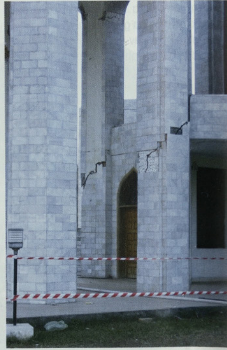
Slika 16 • Muzafarabad, sodna palača: strižne poškodbe neustrezno zasnovanih stebrov
