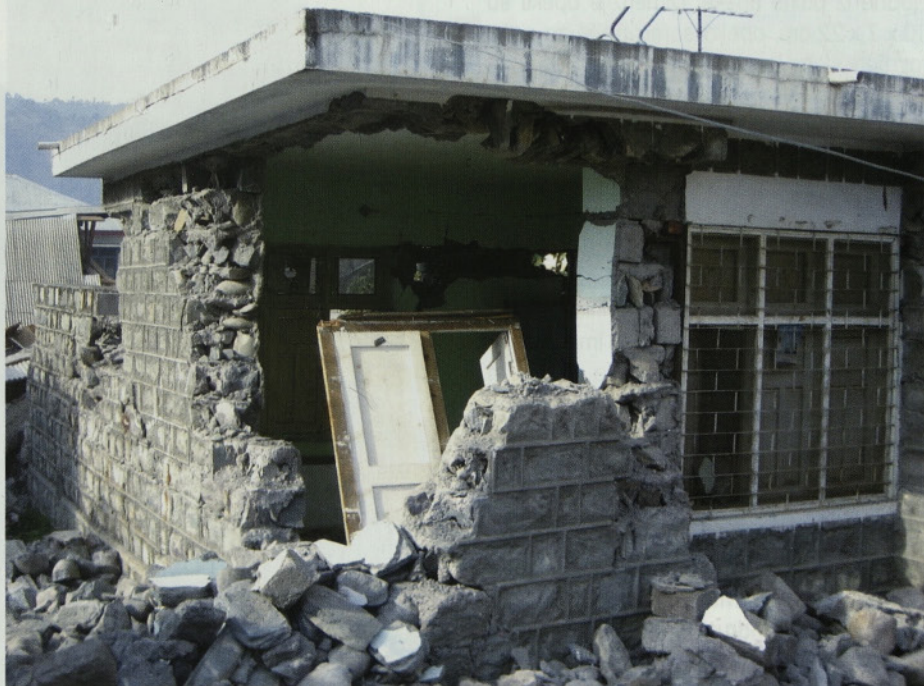
Slika 7 • Razpad kamnitega zidu in odpiranje vogala kljub strešni plošči. Vidi se struktura kamnitega zidu
