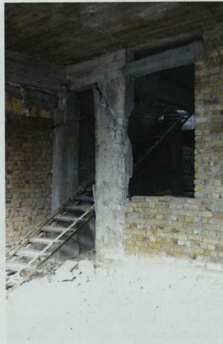
Slika 15 • Muzafarabad: strižna porušitev stebra zaradi oviranih deformacij
