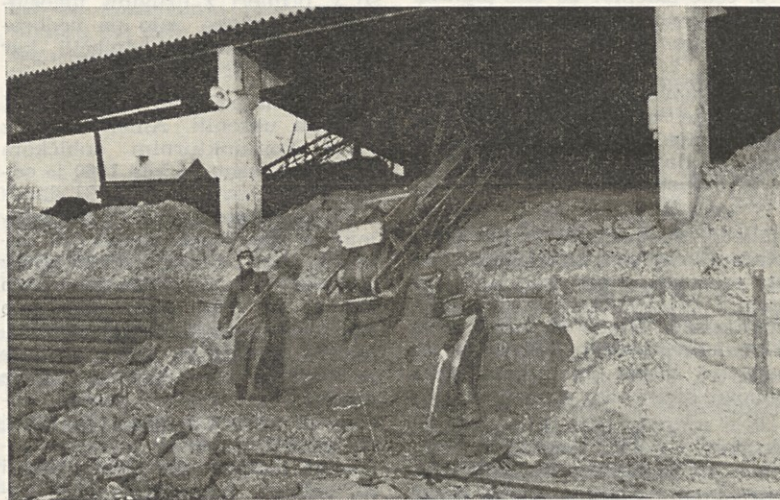
MEDVOĐE — Razkladanje pirita v skladišče priprave kisline je fizično precej naporno delo. Težave pa so še večje, če nastopijo padavine. Zato bi bilo primerno, če bi nad razkladalnim delom železniškega tira napravili streho. S tem pa bi se verjetno tudi zmanjšalo vlaženje in strjevanje
