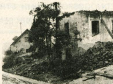
Marsikatero hišo je bilo potrebno podreti, ker po potresu ni več nudila varnega zavetja
