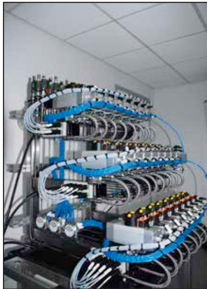
Slika 3. Razdelilnik s kompaktnimi krogelnimi ventili za več kot 20 rezervoarjev za shranjevanje dišav zmanjša izgube v proizvodnji zaradi menjave izdelka. (Foto: Festo AG & Co. KG)
