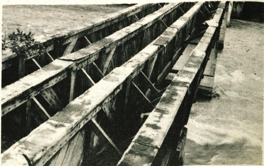
Podrt most čez Savo v Piškovci je »slaba vest« Zasipa, razen tega pa tudi radovliške in jeseniške občine. Krajsani že več let terjajo popravilo. Kaže, da bodo prihodnje leto želje uslišane!
