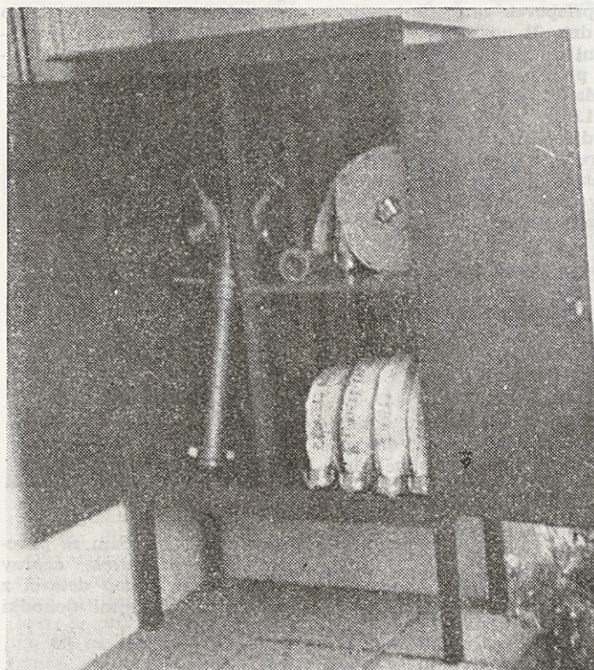
Hidrantna omarica z opremo v neposredni bližini hidranta in skladišča je tudi del samozaščite in preventive.
