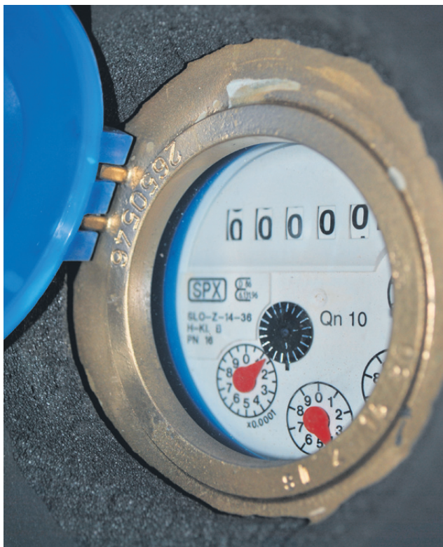
Števec na hidrantu po štirih letih še vedno kaže stanje porabe nič.
