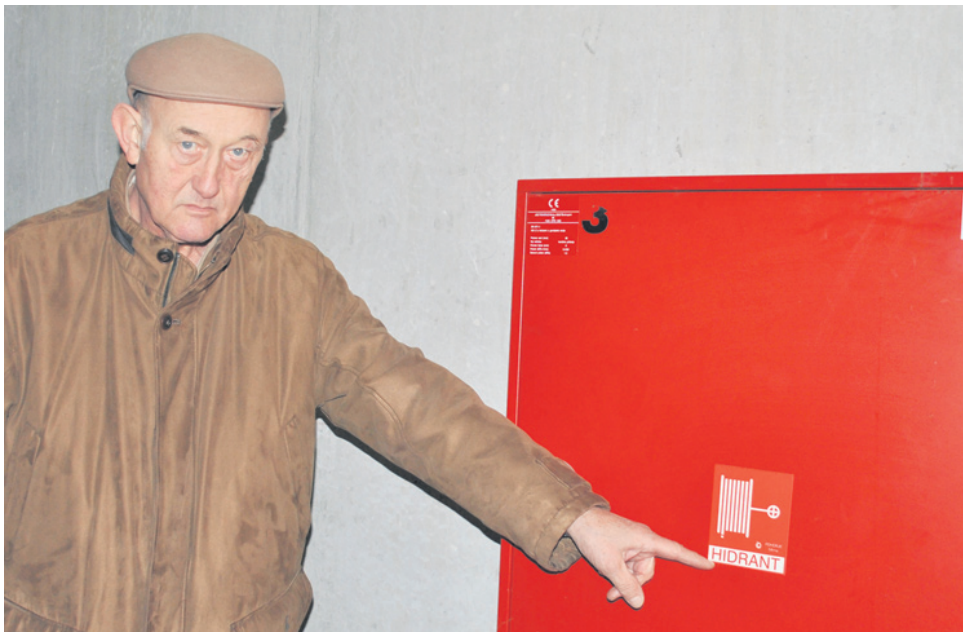
Franc Kokol kaže na še vedno zaplombirane požarne hidrante, iz katerih v zadnjih štirih letih, odkar so bili objekti predani namenu, ni pritekla niti kaplja vode. A kljub temu stanovalci za posamezen hidrant plačujejo 91,55 evra mesečno. Glede na to, da so trije hidranti, JKP Žalec mesečno prejme 274,65 evra, kar v letu zneske skoraj 3.300 evrov.
