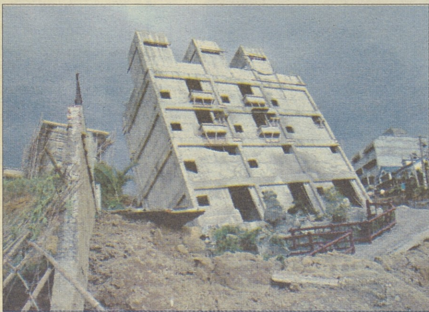
Nedeljski potres na Tajvanu (6, 5 po Richterju) je terjal eno življenje, v povsem nagnjeni stavbi pa ni bil nihče ranjen (Telefoto: AP)
