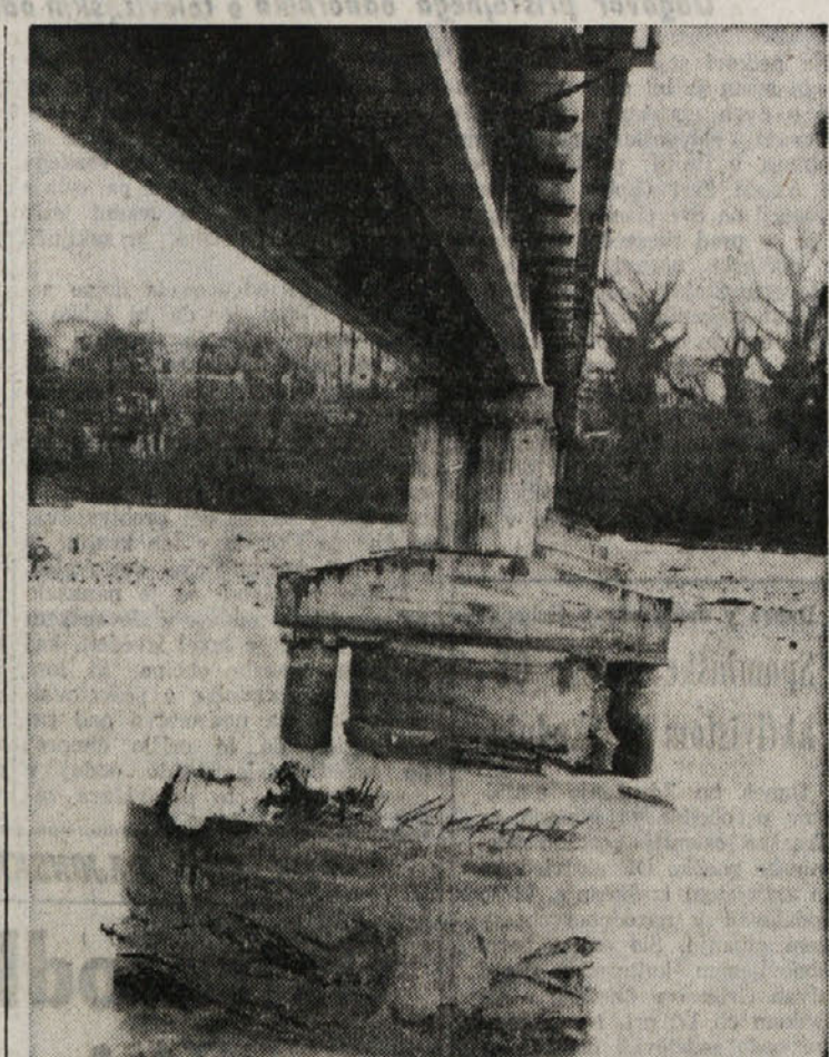
Ko je skozi razpoko v jezru odtekla voda umetnega jezera, so se pod mostom v Podgori pokazali prod in stebri mosta, ki so zaradi popravil za oko kaj neprijetni. Dokler so bili pod vodo, je bilo vse lepo in prav
