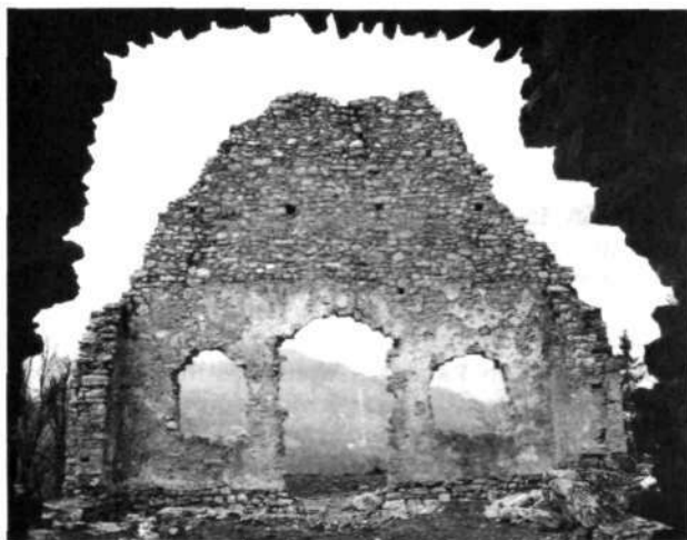
Slika 4. Notranja stran deloma ohranjene zahodne stene ladje s porušenimi vhodnimi in okenskimi odprtinami. Zaznavna je pritlična višina stropa z ometom na steni
