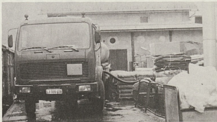
Ob kotlovnicu sta rezervoarja za mazut. Pravkar ga prečrpavajo iz cisterne. Tako smo ga do nedavnega porabili okoli 400 ton, odkar pa ogrevamo še nove prizidke, je poraba narasla na 600 ton.
