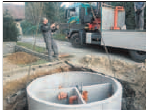
Betonska konstrukcija biočistilne naprave podjetja OJ, d. o. o.
