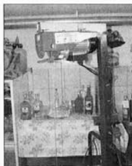
Elektromotor z reduktorjem pritrjen na nosilno konstrukcijo dvigla.
