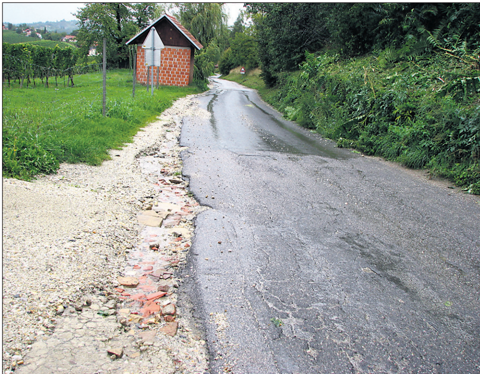
Takšnih, po nevihti razdejanih cestnih odsekih, kot je bil ta nedavno na Kogu, je po občini še veliko, zato je župan Alojz Sok mnenja, da je treba najprej sanirati klance.
