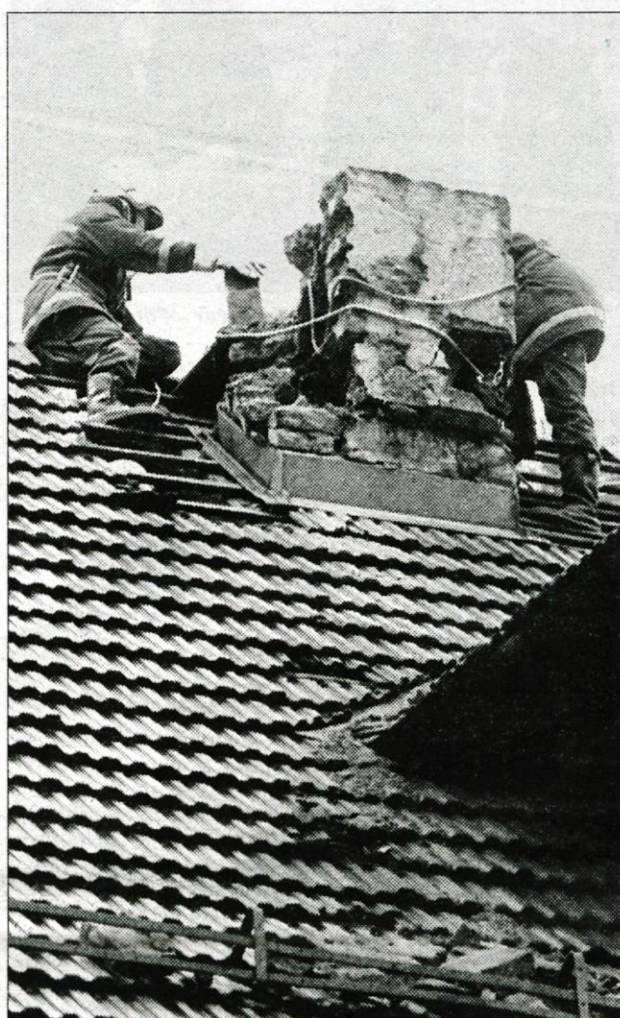
Jeseniški gasilci pri poškodovanih dimnikih.
